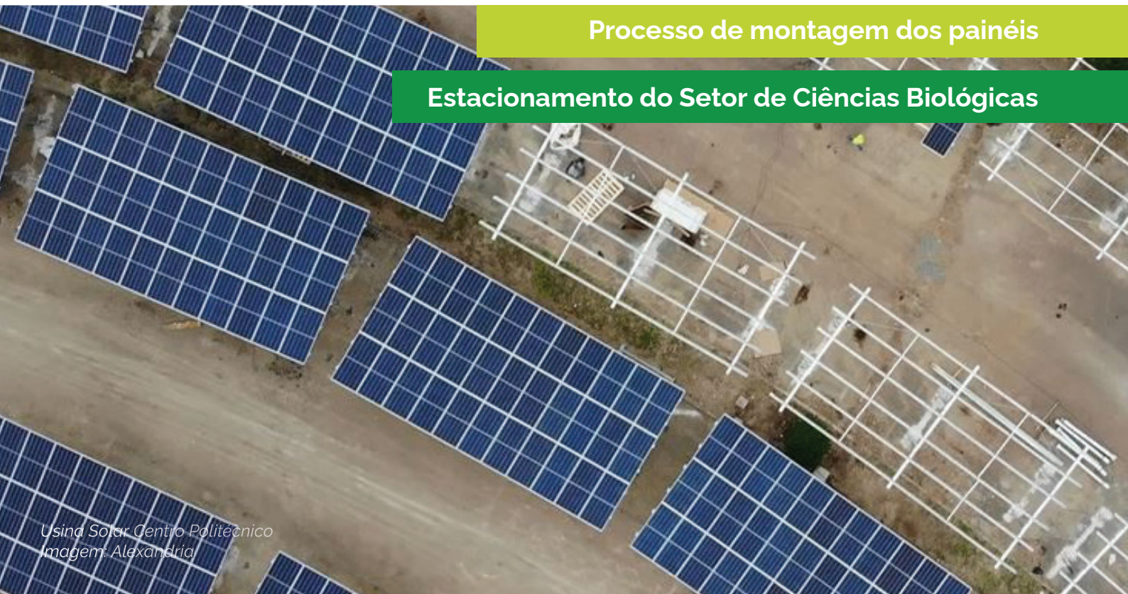
Usina Solar Centro Politécnico Imagem: Marcos Solivan
